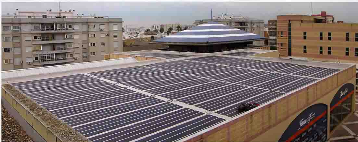
Cubiertas con módulos fotovoltaicos
