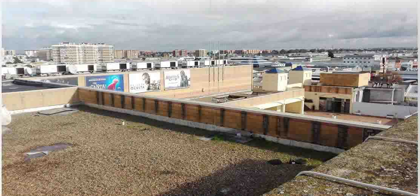
Cubiertas de oficinas, estado inicial
