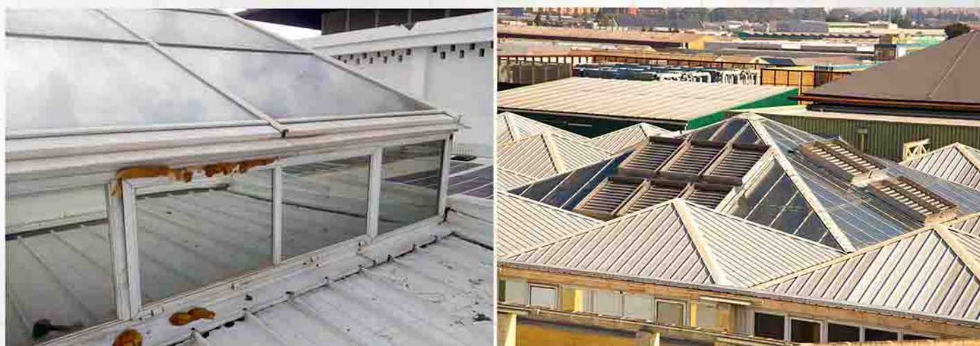
Lucernarios, estado inicial
