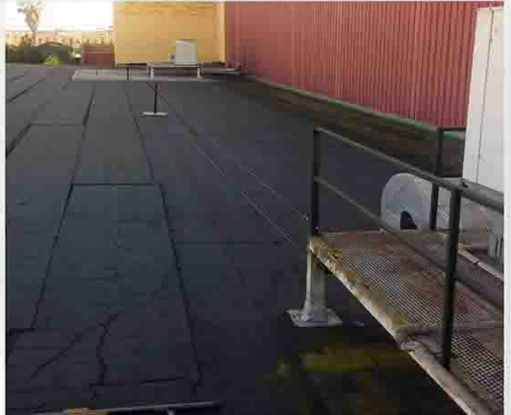
Cubierta de Hipercor, estado inicial
